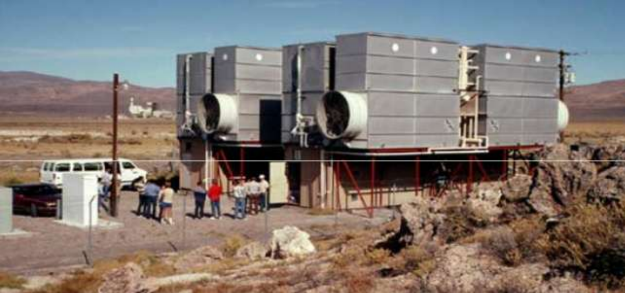
Binarinė geoterminė elektrinė, Wendell-Amadee, Kalifornija (dirba autonominiu režimu). Aušinimas oru
